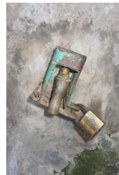
Robinet verrouillé par le chef de ménage pour contrôler l'utilisation de l'eau par les autres membres du ménage afin de conserver la facture d'eau à un prix acceptable.
